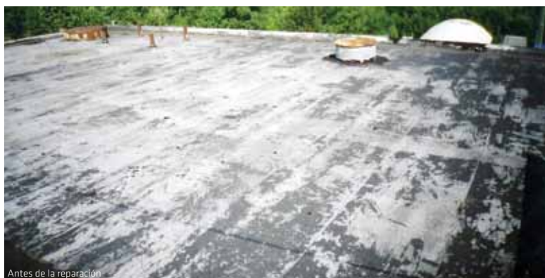
Antes de la reparación
