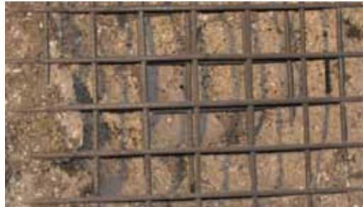
Fig. 5-6: Las altas temperaturas destruyen el hormigón desprotegido
